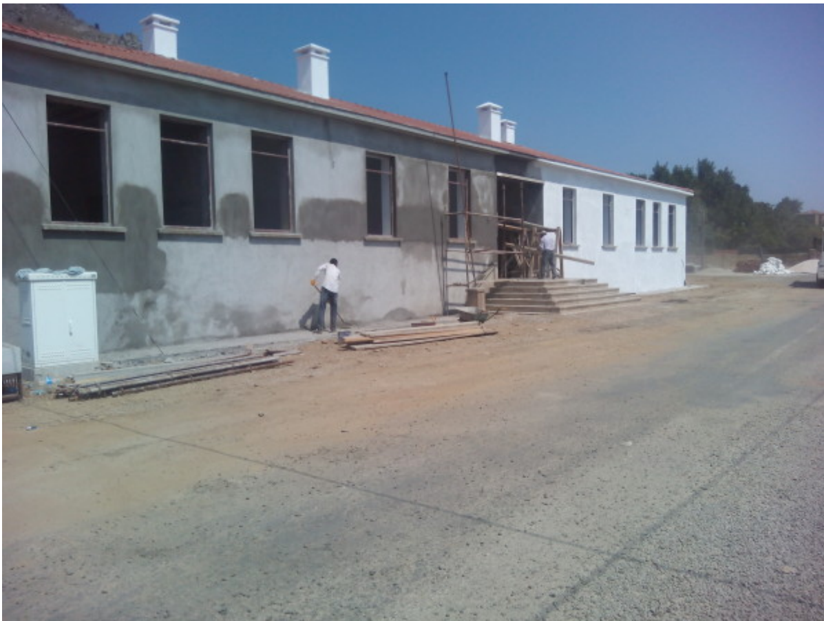
Εργασίες στο νέο Γυμνάσιο-Λύκειο, στα Αγρίδια, μέσα στο καλοκαίρι, ώστε να είναι έτοιμο για τη νέα σχολική χρονιά
