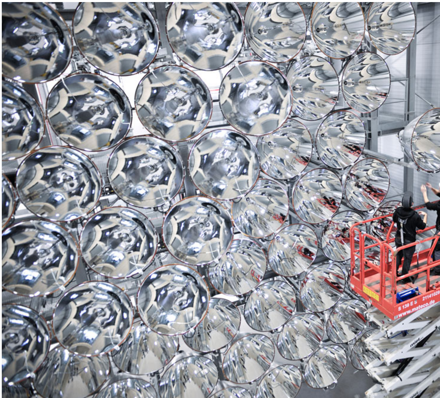
Επιθεώρηση της εγκατάστασης του τεχνητού ήλιου. (Φωτ. www.dlr.de )
