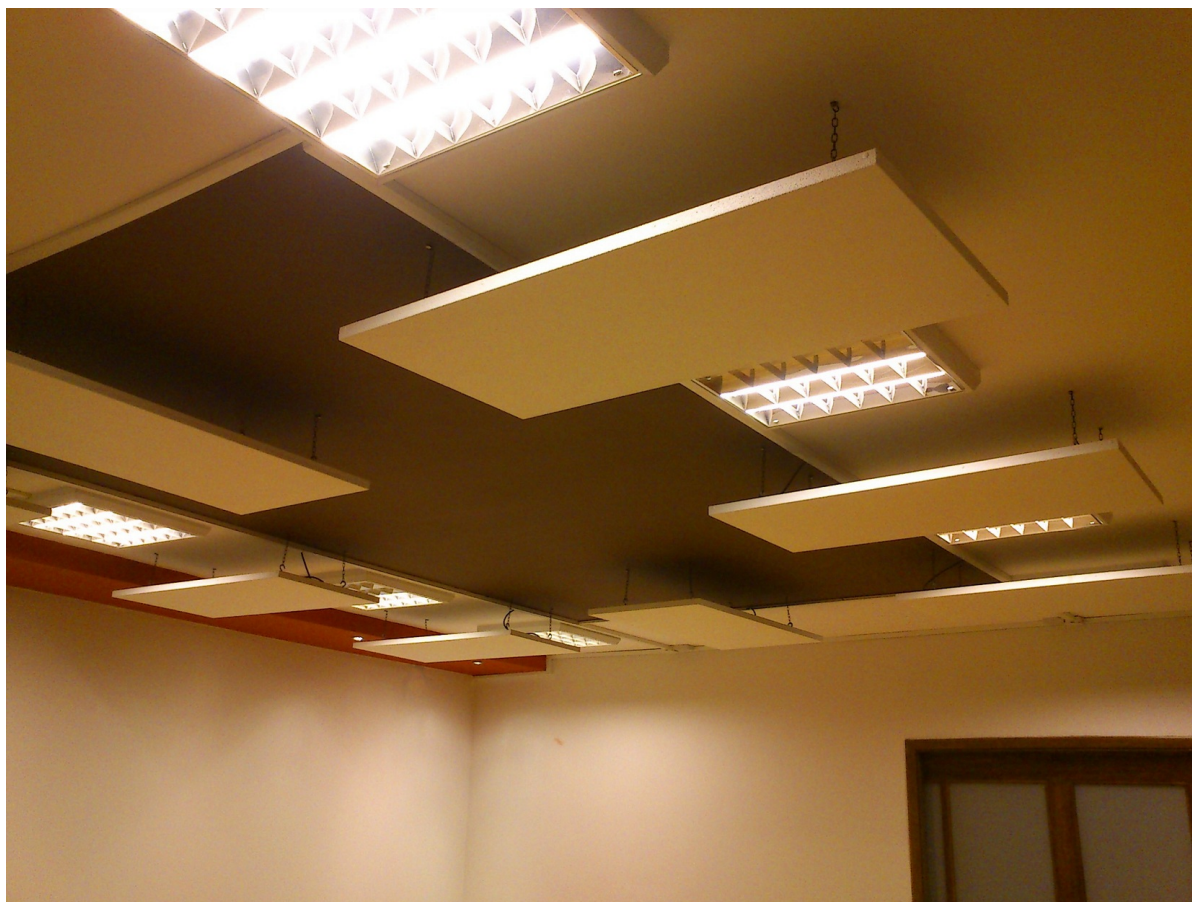
Πάνελ υπέρυθρης θέρμανσης τοποθετημένα στην οροφή (πηγή: www.warmme.co.uk )
